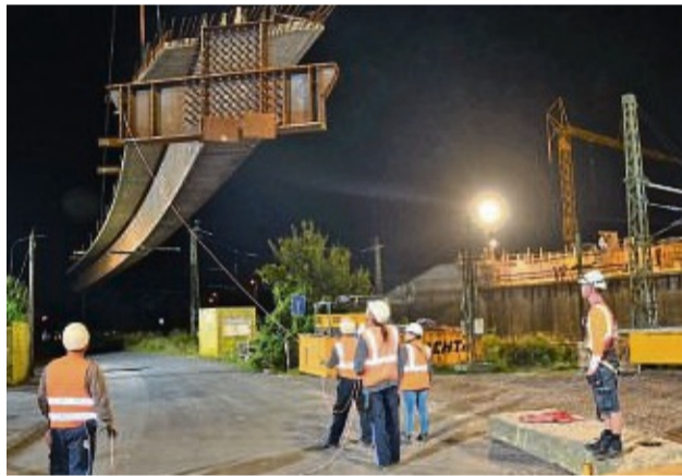
Los geht's: Polier Christian Trinter (von rechts) und Bauleiterin Anne Morell haben das Kommando zum Anheben des Stahlträgers gegeben und beobachten aufmerksam, wie er über die Gleise in Richtung südliches Widerlager bewegt wird.
